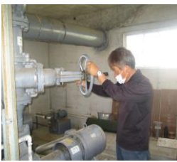
揚水機の機能診断/小入
