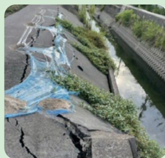
改修が望まれる花宗川護岸
