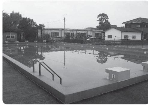
床面に空気が入り防水シートが浮き上がったプール
