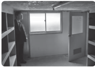
天井が低く使用できない更衣室
