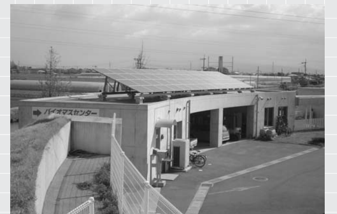
くるるんの太陽光発電設備
