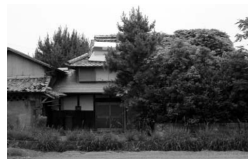
老朽化した空家
