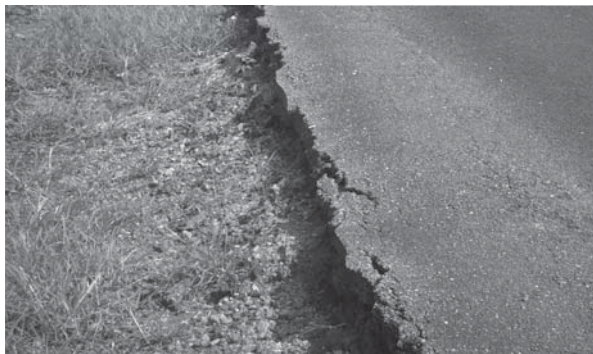
土羽の泥濘化による舗装の崩壊
