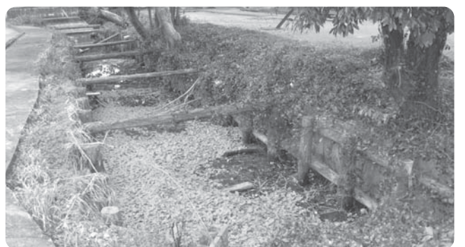
泥土でうまった水路
