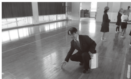
大溝小学校 体育館の雨漏り
