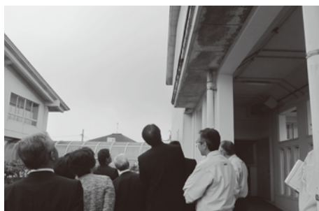
大莞小学校 外壁の剥離
