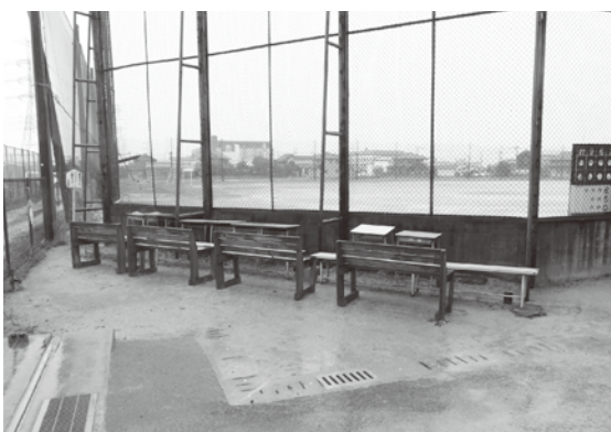
大木中学校 バックネット支柱の老朽化
