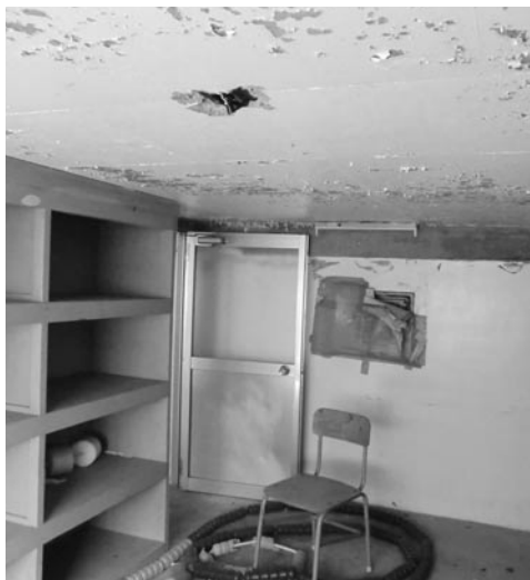
プールの全面改修が望まれているが、まずはプール脱衣室の改修を
