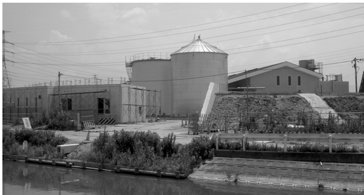
もうすぐ完成、バイオガスプラント
