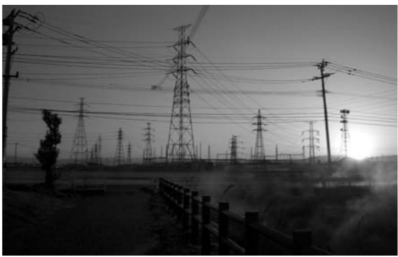
侍島の変電所と鉄塔群
