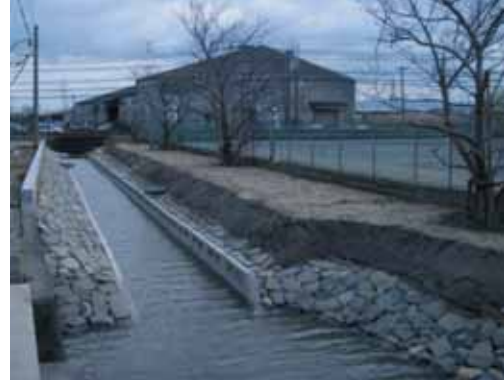
農村環境整備事業 (水路整備事業完成地(多自然型護岸工事))
