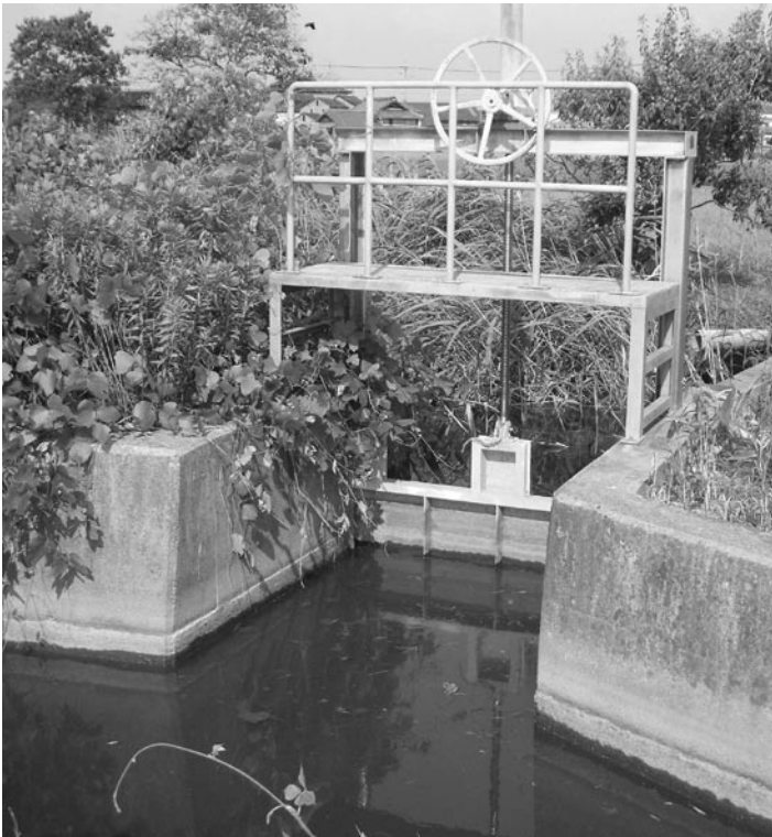
排水門調整による水質改善
