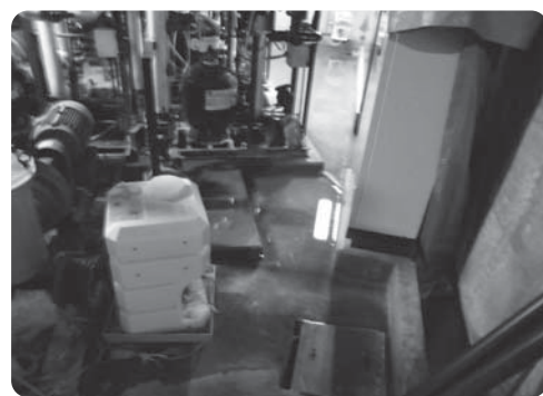
機械室の流水状況
